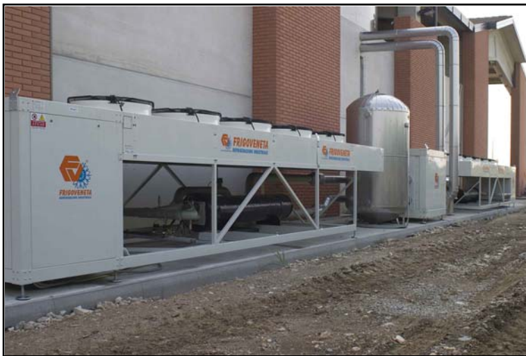
Figura 1 Chiller Frigoveneta, condensatori e serbatoio.
